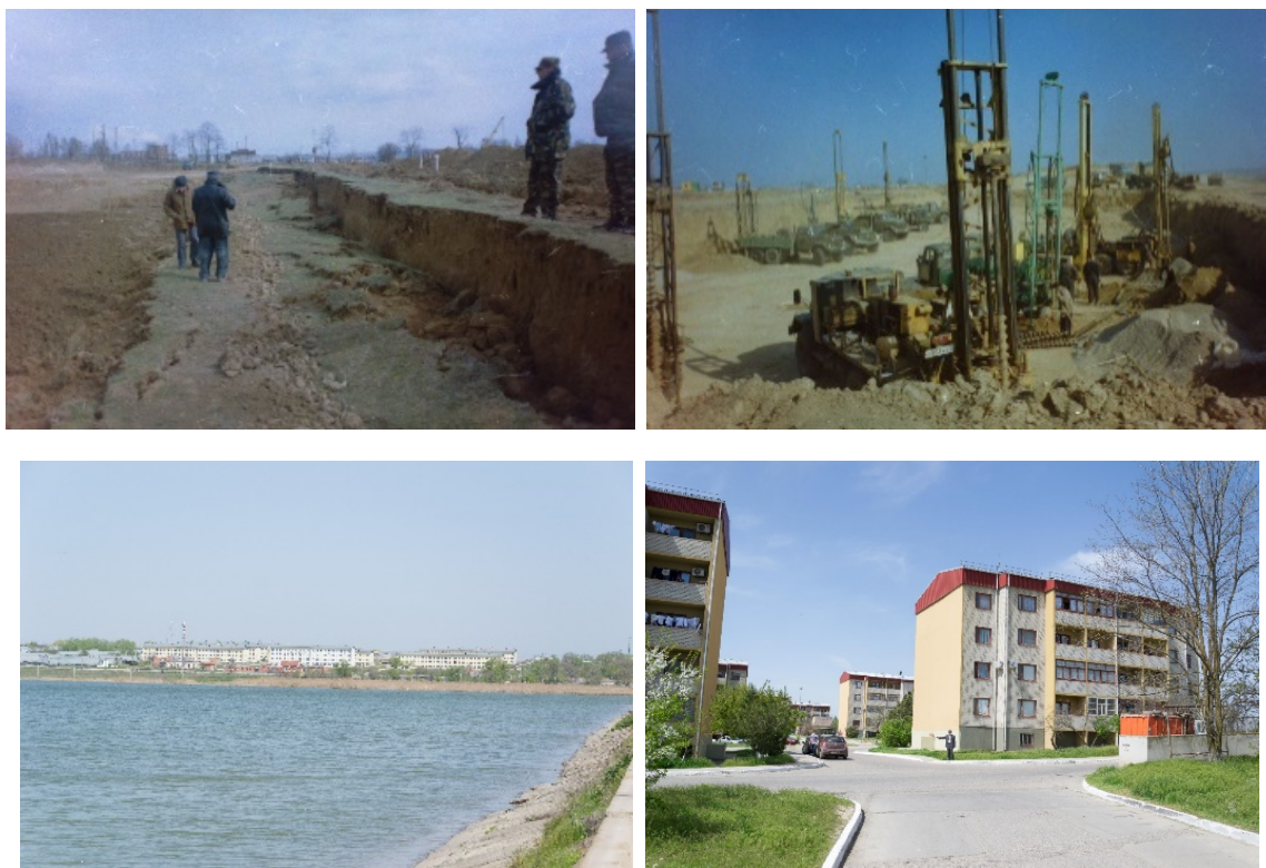
Рисунок 4.10 – А. Просадка котлованов после глубинных взрывов на площадке строительства городка для контрактников. Б. Уплотнение просадочных грунтов шнековыми буровыми установками вблизи существующих казарм вертолетного полка. Вид военного городка с плотины оз. Буйвола.
