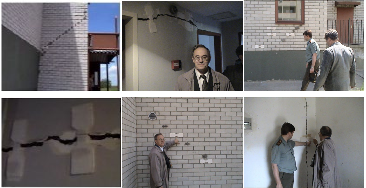
Рисунок 2.8 – Аварийные деформации зданий военного городка «Северный»
