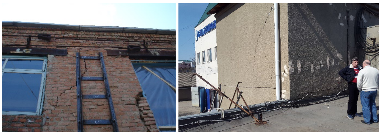
Рисунок 2.6 – Аварийные здания Молочного завода
