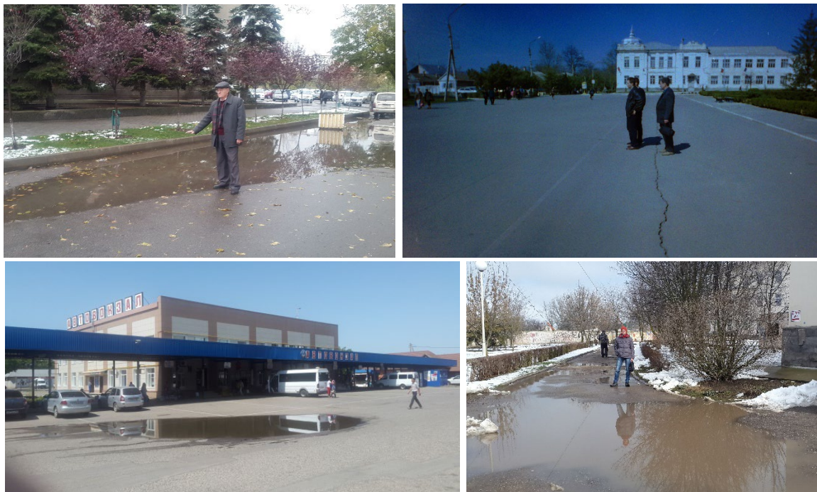
Рисунок 1.3 – Просадочные блюдца на площади Ленина (с трещиной в асфальте после аварии водопровода), на территории автовокзала и больницы
