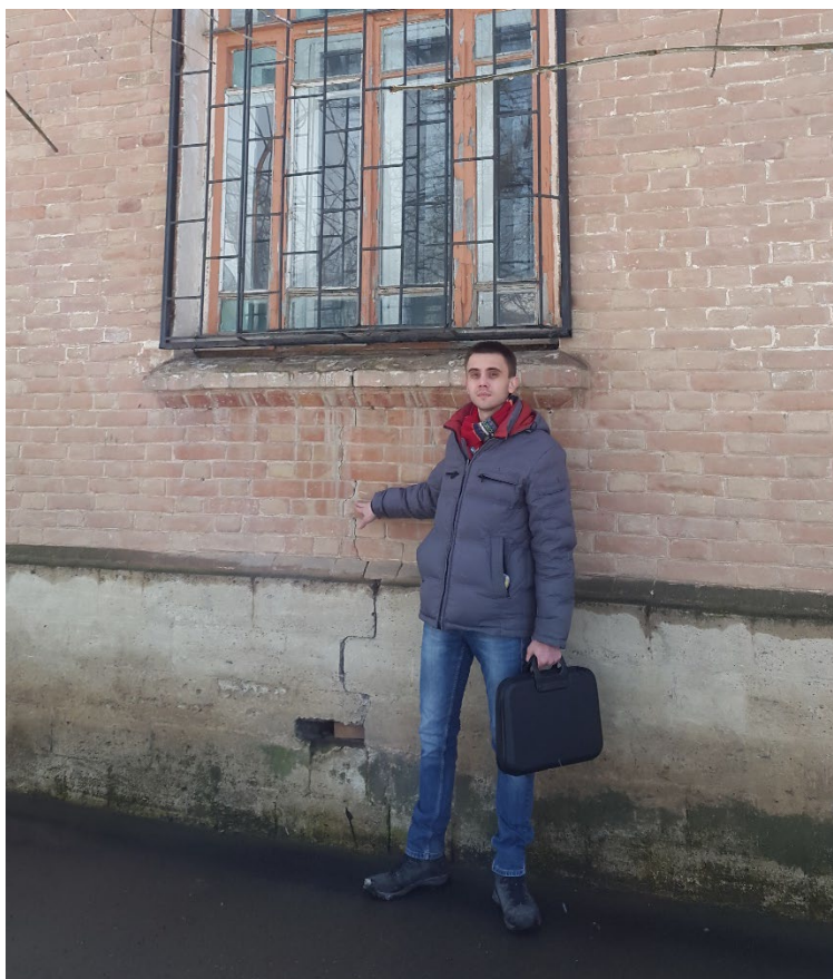
Рисунок 2.5 – Трещины в здании музея
