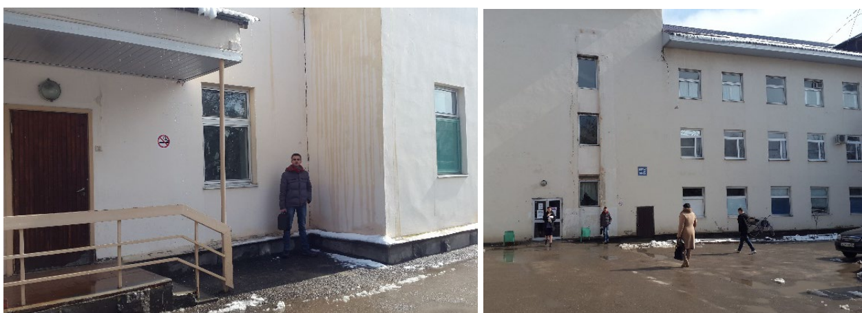
Рисунок 4.12 – Терапевтический корпус (роддом), построенный на забивных сваях длиной 22 м, с трещинами и провалом отмостки.
