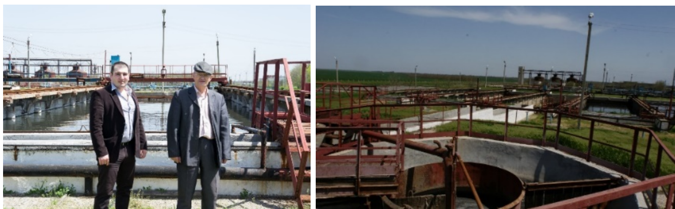
Рисунок 4.6 – Очистные сооружения г. Буденновска
