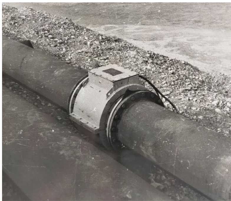
Рис.4.18. Измерение расхода гидросмеси электромагнитным расходомером «Индукция-51».
