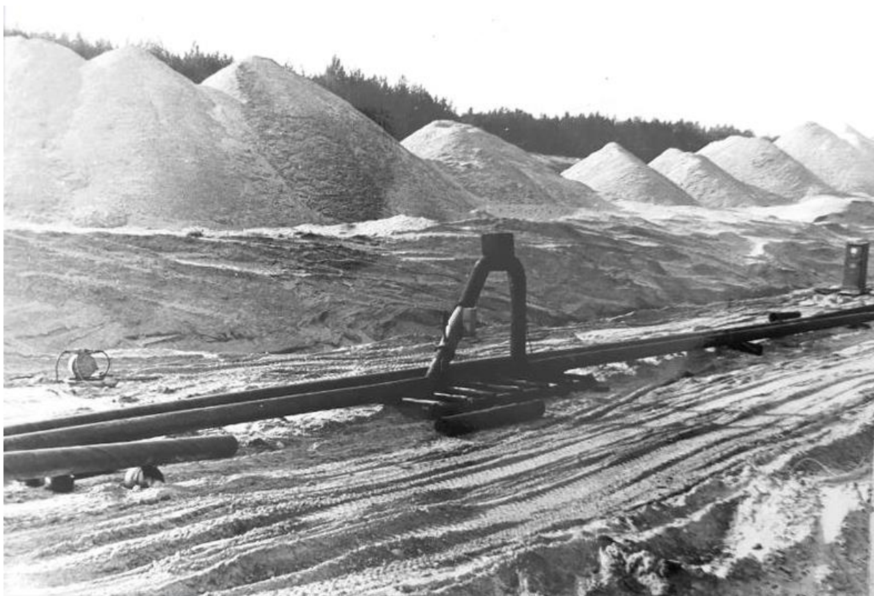
Рис.5.3 б). Передвижная установка измерения параметров гидротранспортирования на расстояние до 2 км из карьера на обогатительную фабрику.
